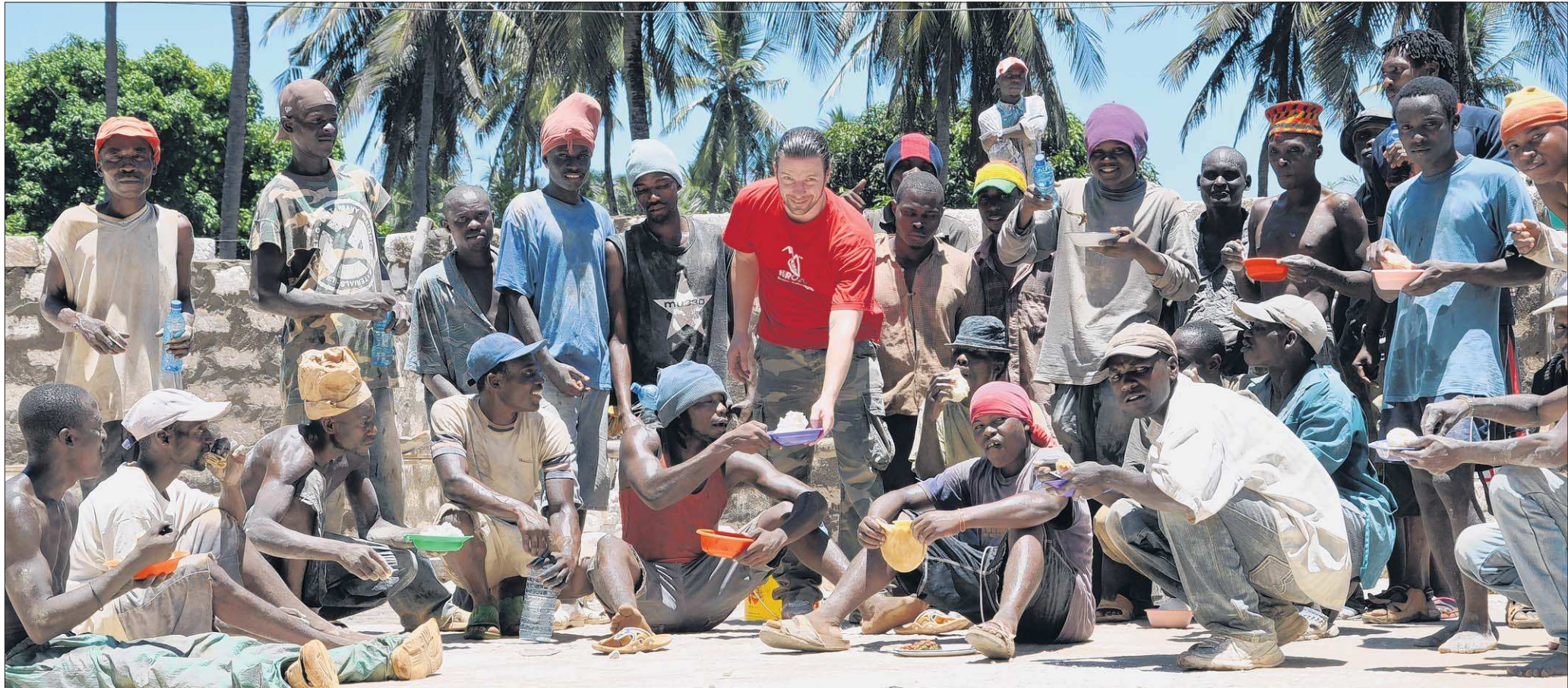
Mittagspause unter der Sonne Afrikas: Christian Hempen aus Belm (Mitte) nimmt gemeinsam mit den Mitarbeitern und Tagelöhnern, die an dem Bau des Waisenhauses in Kenia beteiligt sind, das Mittagessen ein. Fotos: privat
